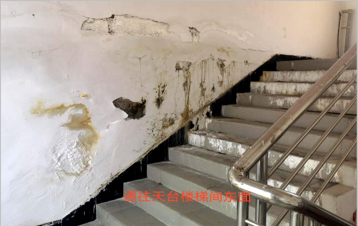
漏水导致二栋西边楼梯墙体脱落
