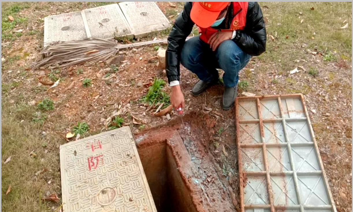
3月1日排查第九栋电塔发现蚁窝，PCO合作单位当日进行处理
