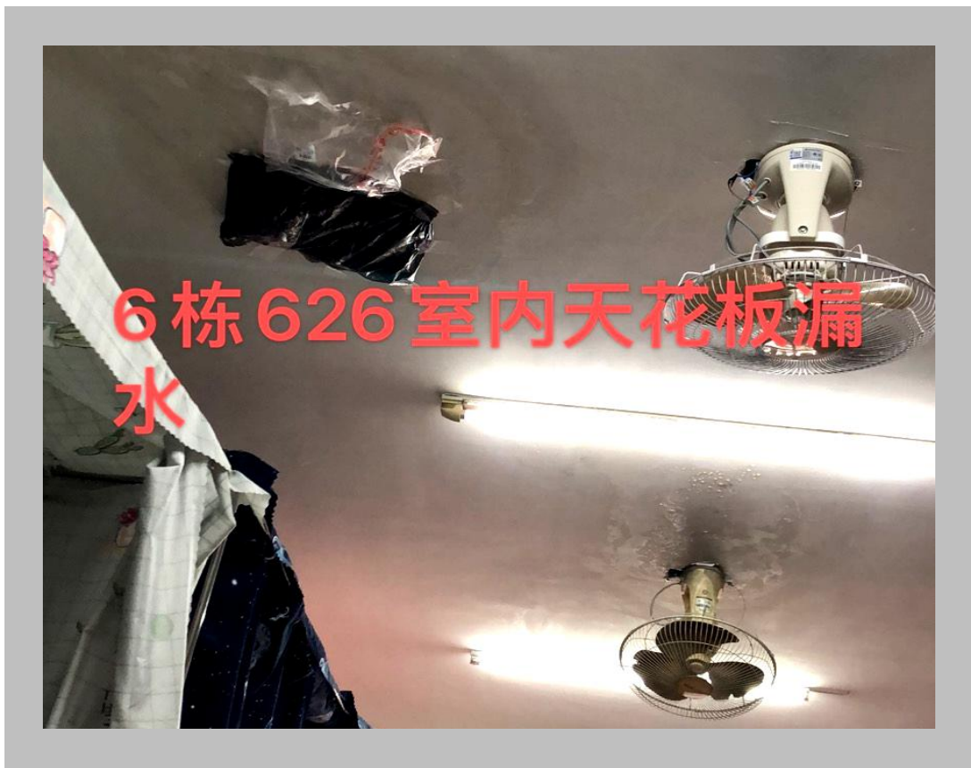
六栋学生宿舍出现天花板漏水
